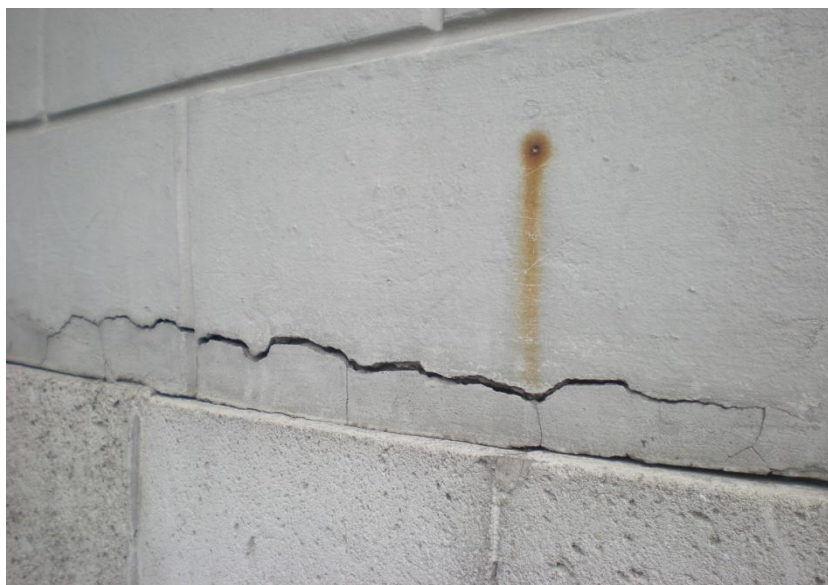
105. fénykép. Süllyedés okozta épületkár a Bécsi kapu tér 1. sz. házon.
