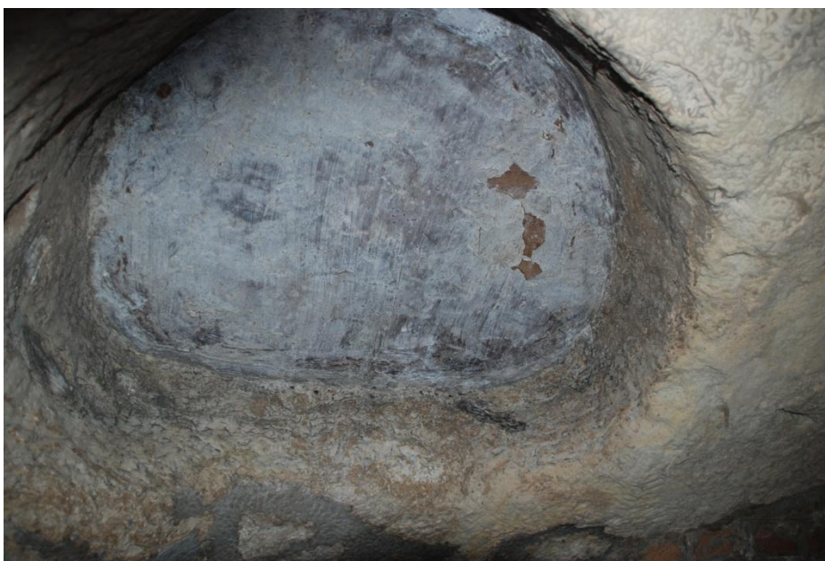
66. fénykép. Mennyezeten elzárt kürtő a 193-as járatban.
