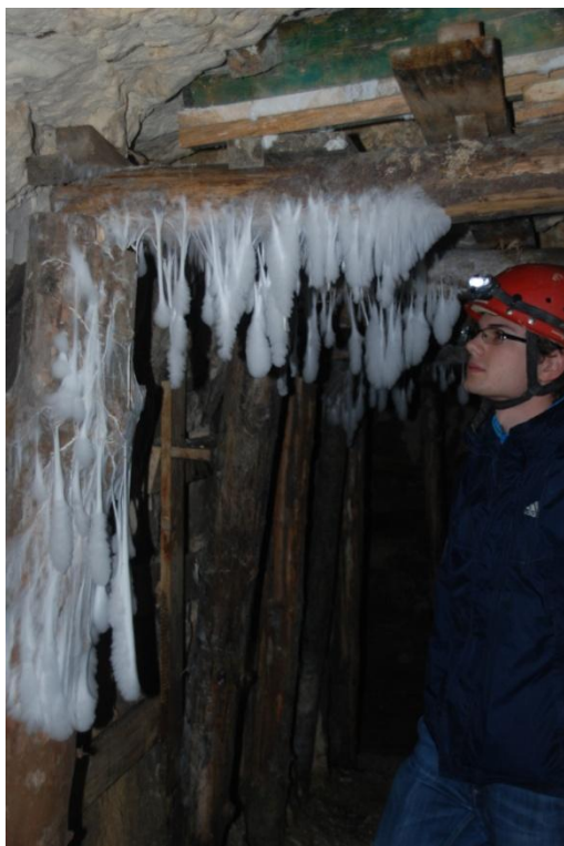
97. fénykép. Penész az új ácsolaton a Bécsi kapu tér alatti járatrendszerben.
